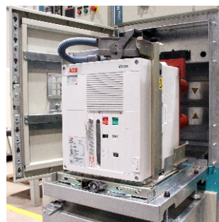
Compartimento do disjuntor/contator.
