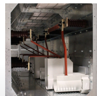
Compartimento dos barramentos.
