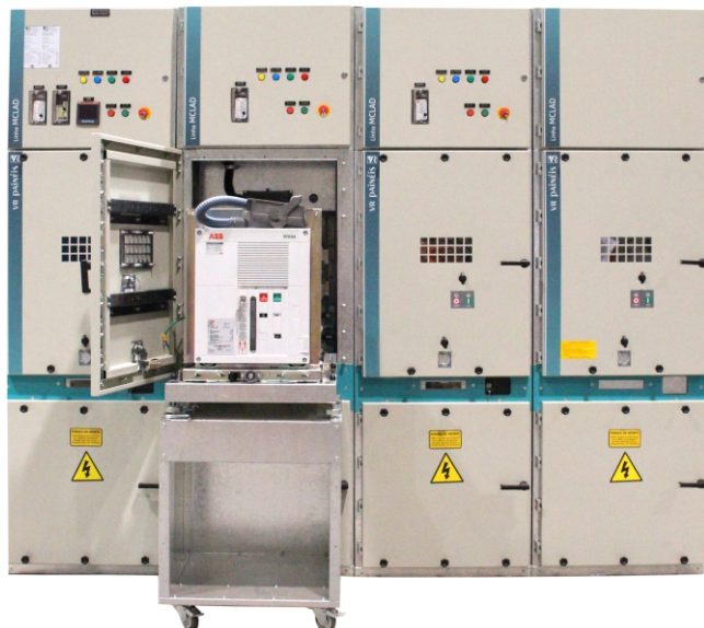
Cubículo de Média Tensão MetalClad, vista frontal com mesa para remoção do disjuntor.
