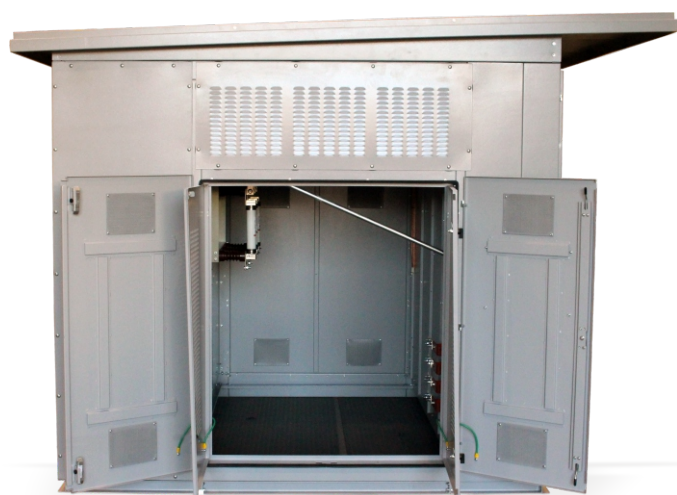
Compartimento do disjuntor
