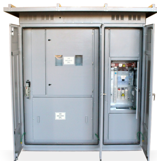
Proteção geral baixa tensão
