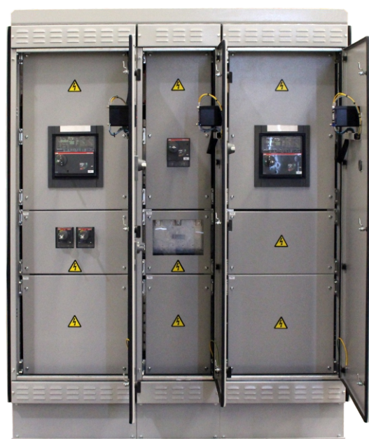
Vista frontal interna da Cabine de Barramentos
