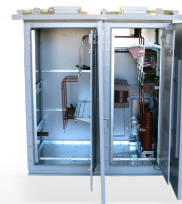
Vista traseira interna medição e proteção
