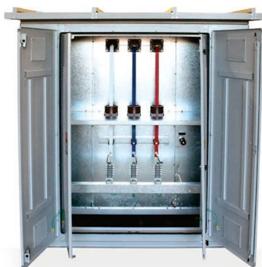
Entrada da concessionária média tensão
