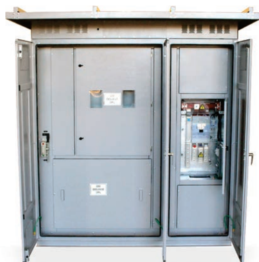
Proteção geral baixa tensão
