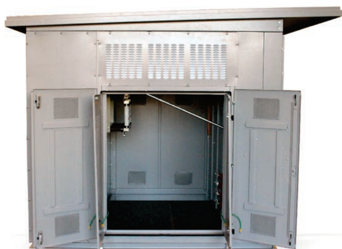
Compartimento do disjuntor
