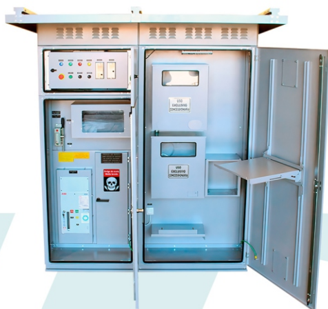
Vista frontal interna medição e proteção.
