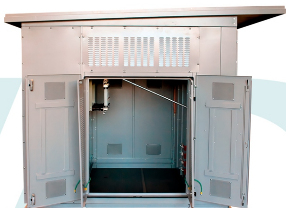
Compartimento do disjuntor.
