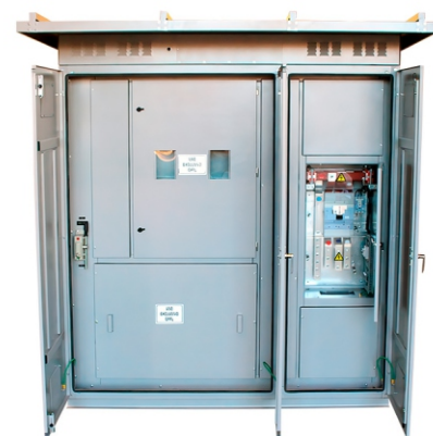
Proteção geral baixa tensão.
