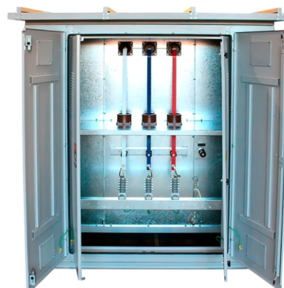
Entrada da concessionária média tensão.
