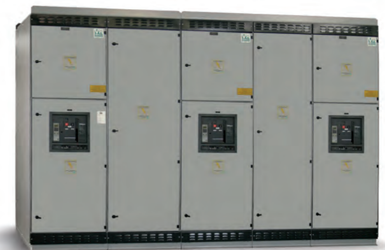
Cabine de Barramento Padrão Eletropaulo/Bandeirantes
